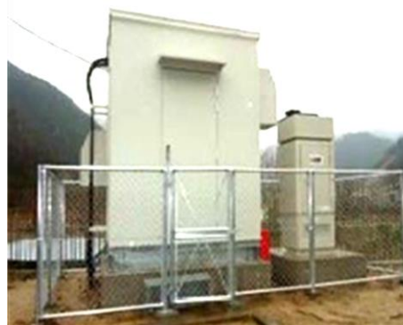
出合基地局 全景
